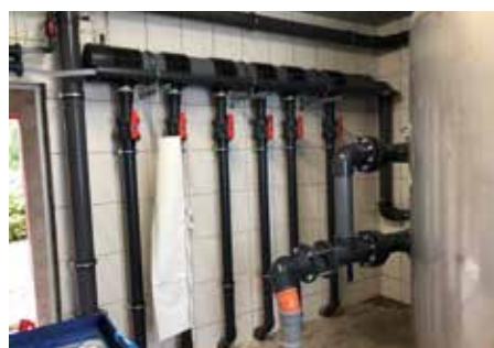
Die neue technische Anlage im Freibad Hünstein
