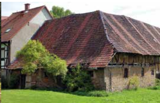
Die einsturzgefährdeten Stallgebäude, 2008
